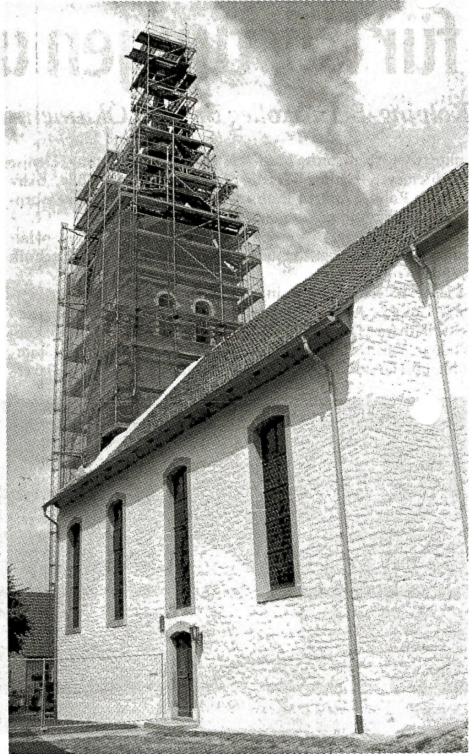
Eingerüstet: Mit dem Anstrich des Turmes der St. Mauritius Pfarrkirche Rösebeck wird die Außenrenovierung abgeschlossen. FOTO: FLÖR
